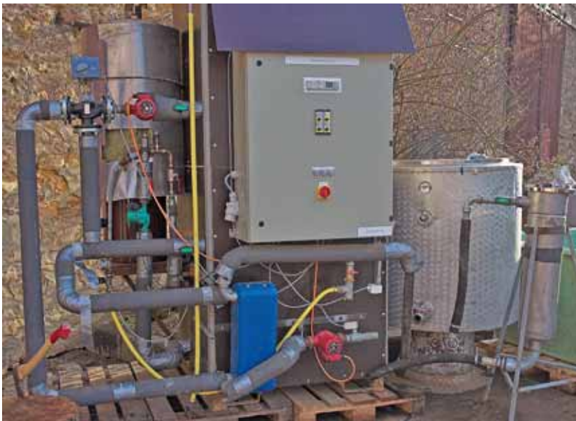
Bild 1: Heißwasserbeizanlage der LBS Dfhof: inks: Feuerung, Mitte: Temperatursteuerung, rechts: Tauchbecken (Foto: S. Klause)
