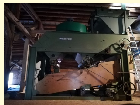
Abb. 3: Siebaufbereitungsanlage auf Gut Mönchhof
